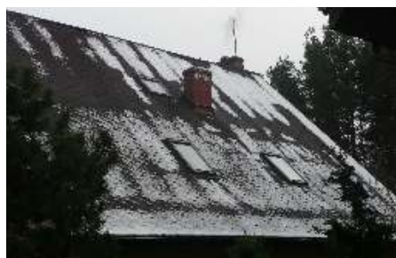
Fot. 1. Mostki termiczne przez drewnianą konstrukcję dachu (więźbę), widoczne w miejscach topnienia śniegu.
