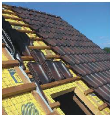
Fot. 6. Układanie dachówek na oszalowaniu. Na dole po prawej widoczne miejsce na montaż okna dachowego.
